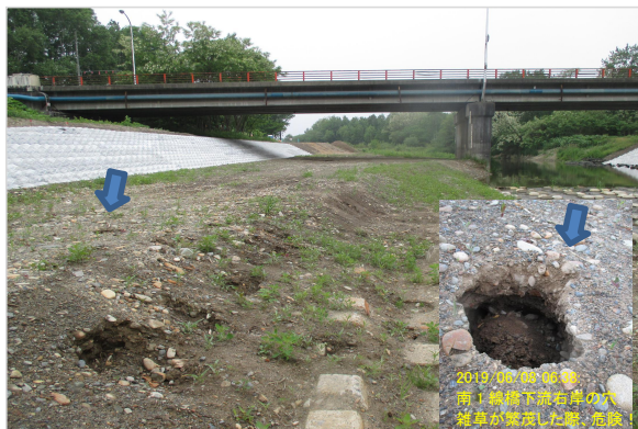
南一線橋下流の堤防に見られた陥没（振興局へ報告）
